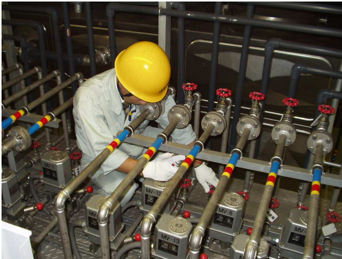
◇ 排水設備の点検
