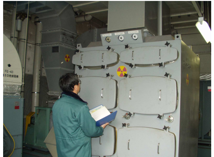
◇ 排気設備の点検
